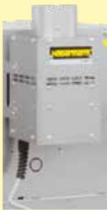
Chimney with fan
